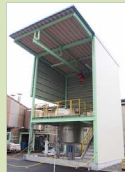
(高品位尿素水溶液新設備)
